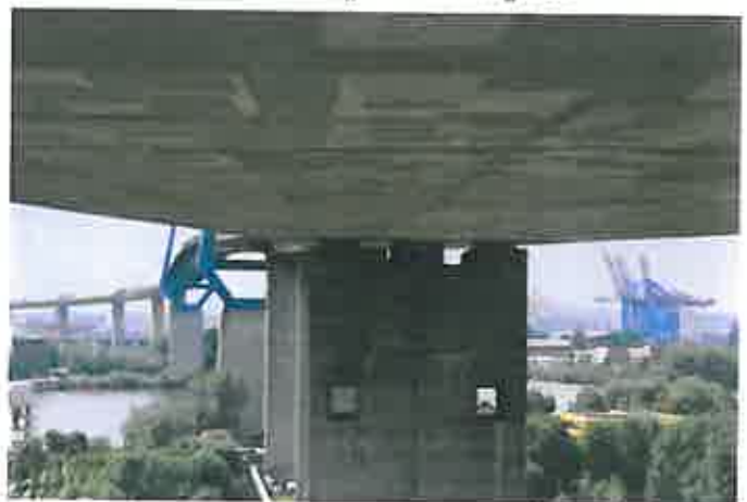
Abb. 5: Schadstelle im Beton mit freiliegenden Bewehrungseisen
