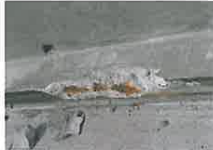
Abb. 8: Abgeplatzter Beton an den Randkappen mit darunter liegenden Korrosionsschäden der Bewehrung
