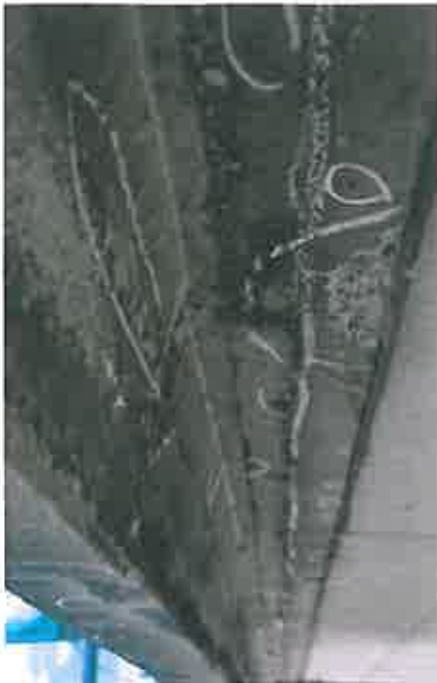
Abb. 6: Stück für Stück wird die Brückenunterseite abgeklopft und auf Hohl- und Fehlstellen überprüft, sämtliche Schadstellen werden mit Kreide markiert
