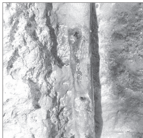
Lochfraß in Betonstahl
