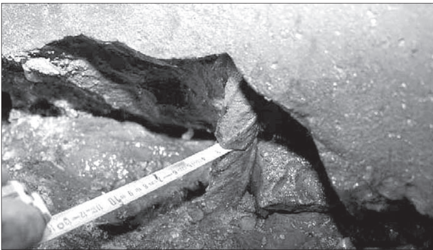
Durch Ermüdung gebrochener Stahl in einer Schleuse
