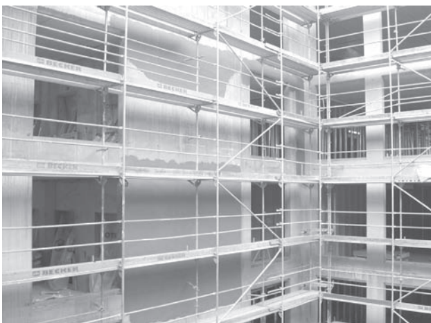
Bild 4: Fassade mit bereichsweise überschrittenen Rohbautoleranzen
