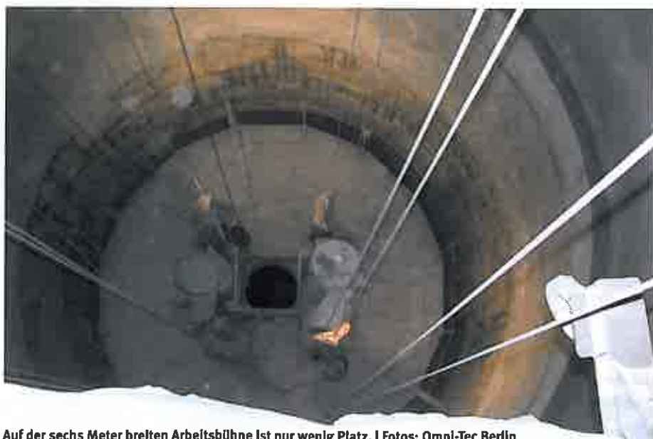
Auf der sechs Meter breiten Arbeitsbühne ist nur wenig Platz. | Fotos: Omni-Tec Berlin
