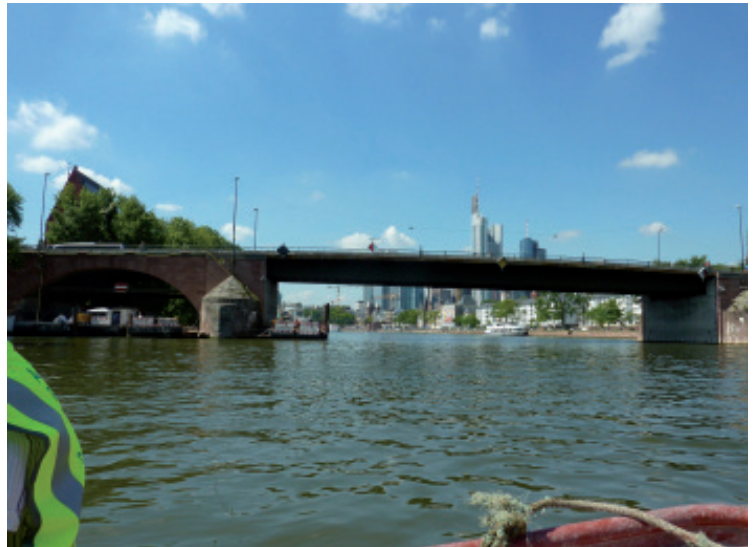
Die Alte Brücke in Frankfurt am Main: Bei Untersuchungen erwiesen sich die Pfeiler der Alten Brücke in Frankfurt am Main als äußerst marode. Eindringendes Wasser hatte den Fugenmörtel teilweise ausgewaschen.
