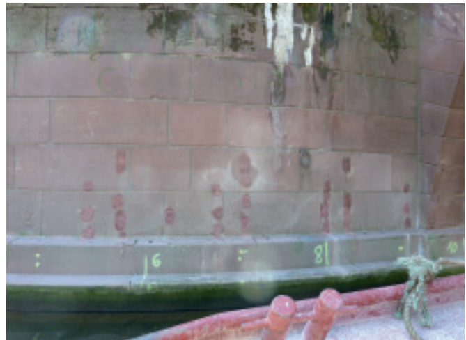
Die wieder verschlossenen Bohrersatzpunkte. Insgesamt wurden an den 14 Pfeilerseiten etwa 2200 Einzelbohrungen bzw. knapp 17.500 Bohrmeter durchgeführt und rund 1,1 Millionen Liter Bindemittel eingefüllt.
