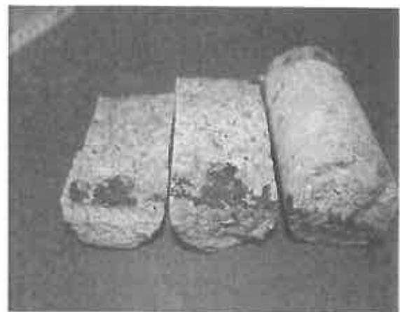
Bild 8: deutliche Korrosion der Bewehrung
