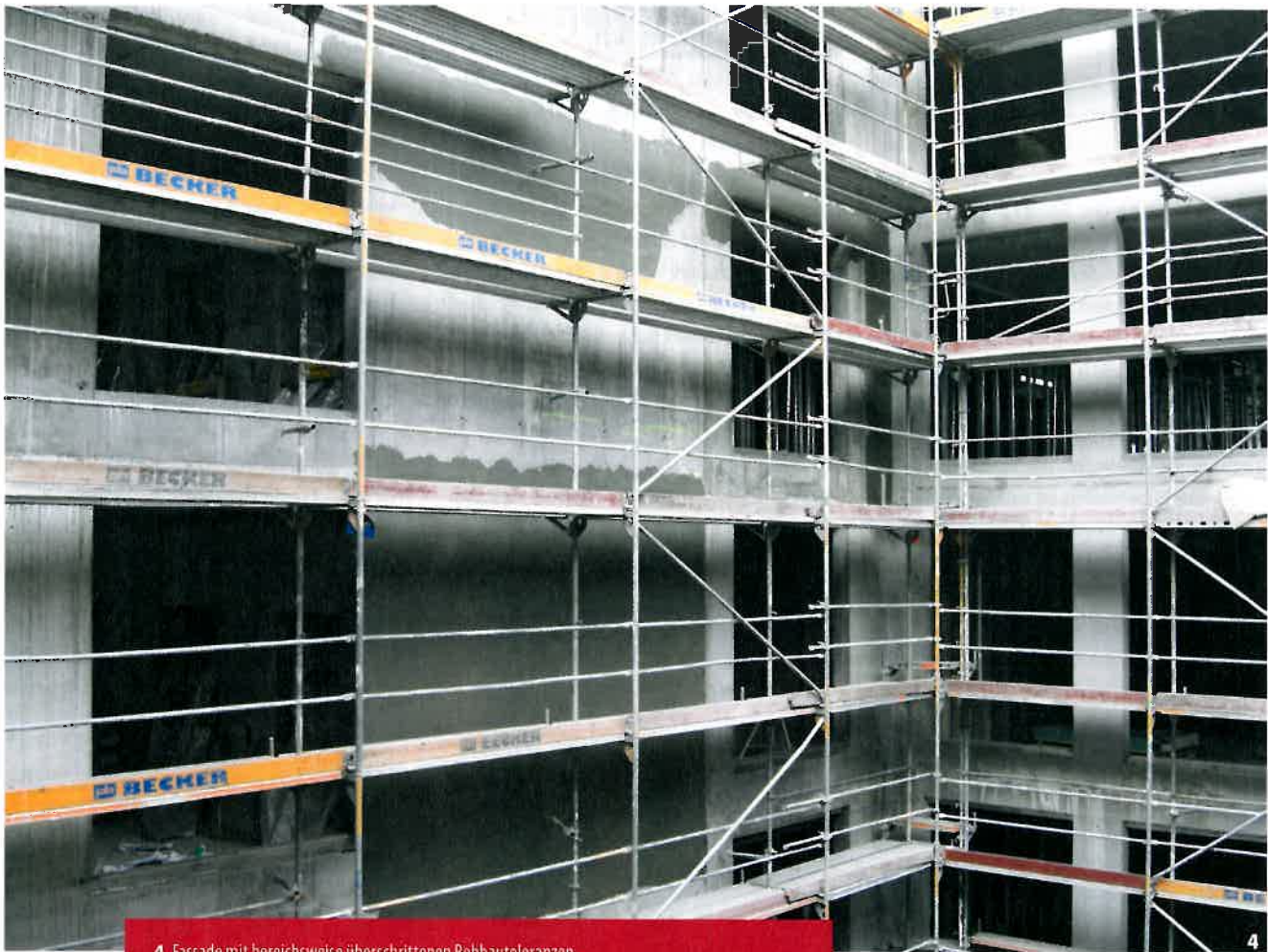
4 Fassade mit bereichsweise überschrittenen Rohbautoleranzen
