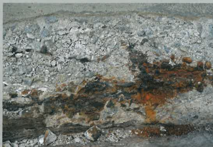
Typischer Schaden an Brücken: Abgeplatzter Beton an den Randkappen mit darunter liegenden Korrosionsschäden der Bewehrung.
