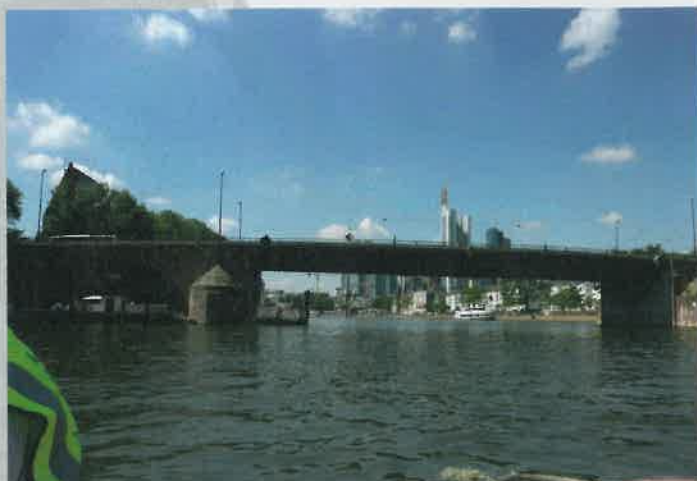
Die Alte Brücke in Frankfurt am Main: Bei Untersuchungen erwiesen sich die Pfeiler als äußerst marode.
