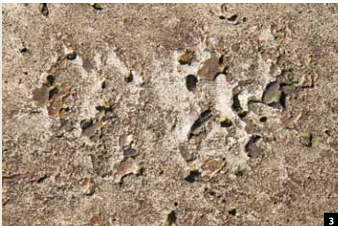
Abb. 3: Mangelhafte Verarbeitung und der fehlende Oberflächenschutz waren die Ursachen für Schäden an der Fassade. Neben Rissen und Kiesnestern, die sich an der Fassade zeigten,...
