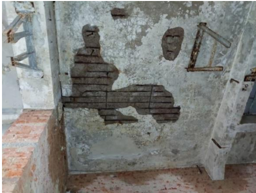
Abbildung 1: Korrosionsschäden an Stahlbetonbauwerk (Foto: CARBOCON GMBH)
